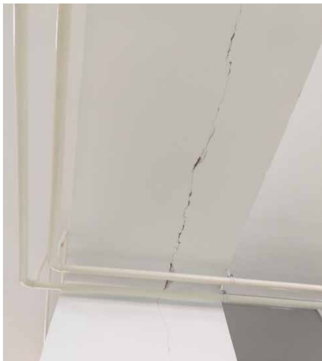
Razpoke na hodniku v prvem nadstropju
